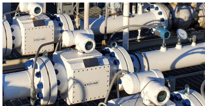
Eichpflichtige Durchflussmessung für ein Brenngassystem
