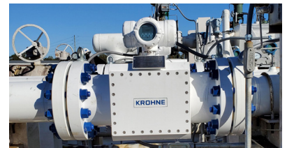
Eichpflichtige Durchflussmessung von Erdgas
