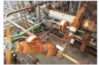
Erneuerte Druckentnahmestelle mit Flansch
