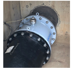
Durchflussmessung der eingeleiteten Wassermenge mit dem OPTIFLUX 2300 W
