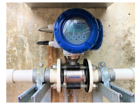
Durchflussmessung von Aluminiumsulfat mit dem OPTIFLUX 7300 C
