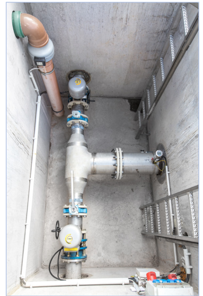
Überdruckmessung in einer Belüfterleitung mit dem OPTIBAR PM 5060
