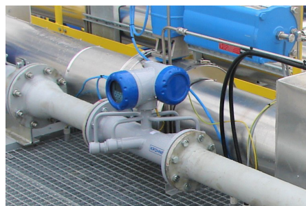
Měření průtoku vodíku ultrazvukovým průtokoměrem OPTISONIC 7300
