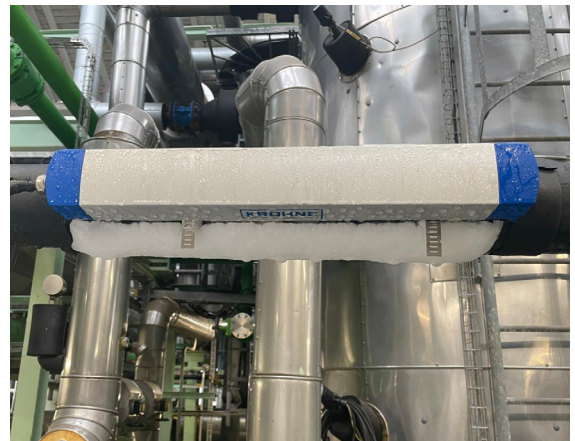
Durchflussmessung von Kühlsole mit dem OPTISONIC 6300
