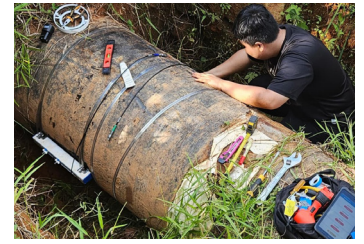
Inbetriebnahme von OPTISONIC 6300 P mit zwei Messwertaufnehmer-Schienen
