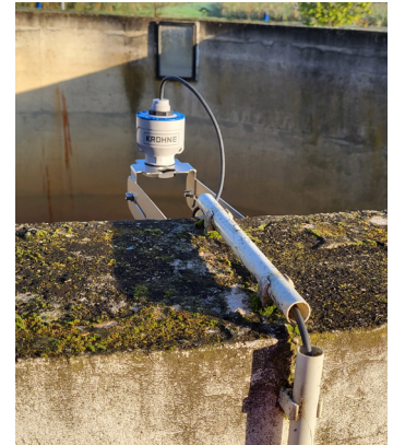
Füllstandüberwachung von Prozesswasserspeicher mit dem OPTIWAVE 1540
