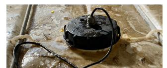
Capteur de niveau de pression précédemment installé dans les réservoirs type IBC (GRV)
