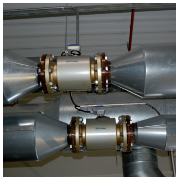
Heißwasser-Messung im Sudhaus
