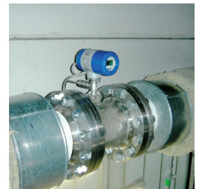
OPTISWIRL 4070 DN 200 an einer Messstelle unmittelbar hinter einem Dampfkessel
