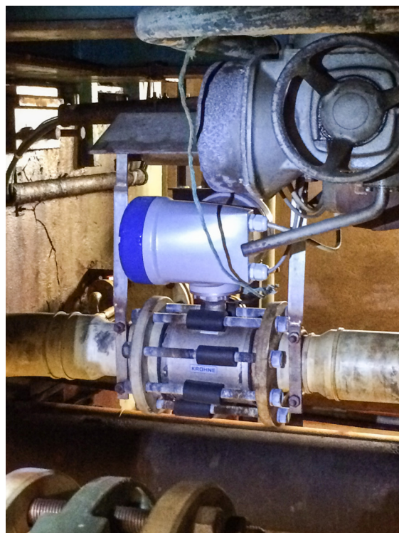
Измерение расхода электролита с помощью электромагнитного расходомера OPTIFLUX 5300
