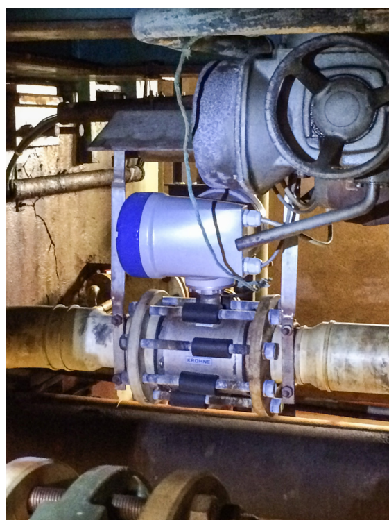
Mesure de débit d'électrolyte avec le débitmètre électromagnétique OPTIFLUX 5300
