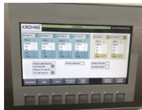
Füllstandüberwachung über die speicherprogrammierbare Steuerung (SPS)
