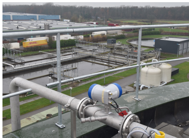
Biogas-Durchflussmessung hinter dem Fermenter
