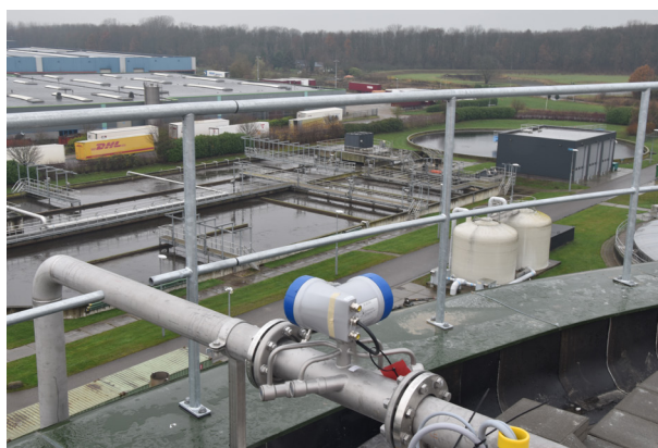
Měření průtoku surového bioplynu za vyhnívací nádrží
