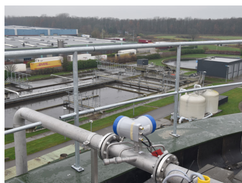
Mesure de débit de biogaz derrière le digesteur
