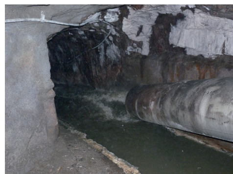
Водоспуск в канализационную сеть
