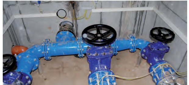
Répartition de la conduite d'eau principale en 3 lignes de distribution
