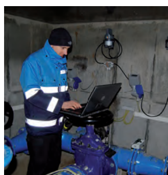
La configuration des KGA 42 par le technicien S.A.V. KROHNE
