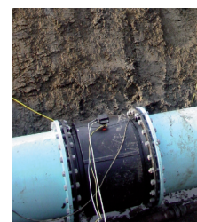
Montage enterré du capteur de mesure
