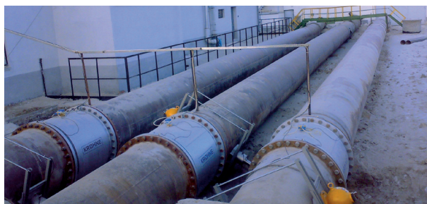
Три трубопроводных линии с расходомерами
