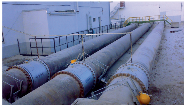
Drei Rohrleitungen mit Durchflussmessgeräten
