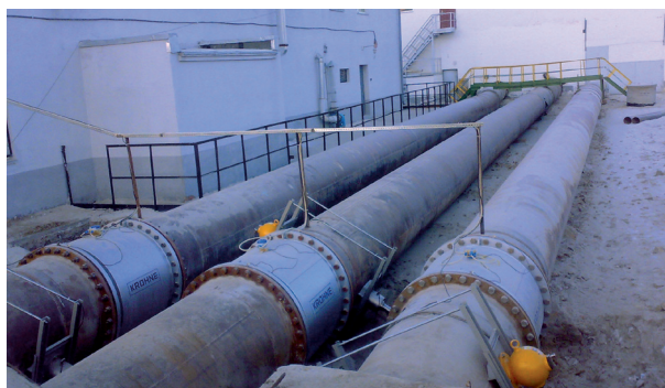
Trois conduites équipées de débitmètres
