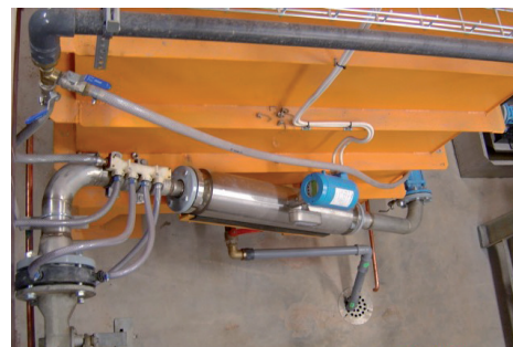
Расходомер, установленный на объекте
