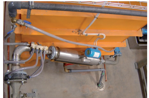
Vor Ort montiertes Messgerät
