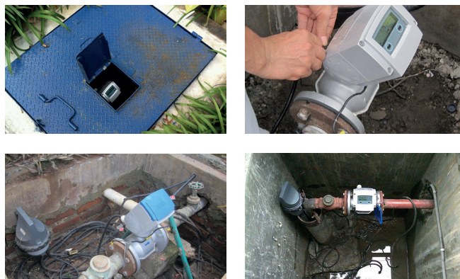
WATERFLUX 3070 C et KGA 42 installés en différents endroits
