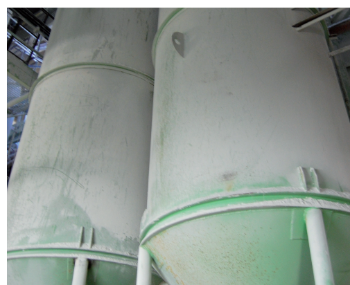
Резервуары для стеклянного гранулята на предприятии Vestglas
