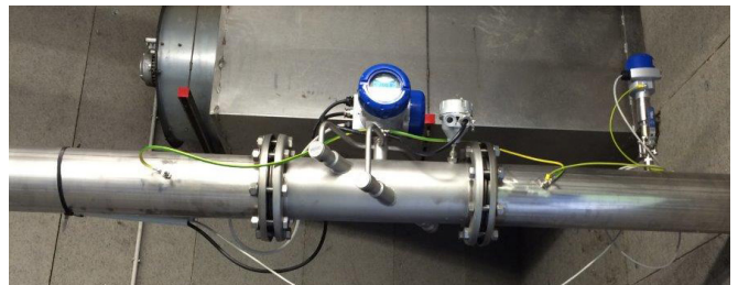
Installation des OPTISONIC 7300 Biogas hinter dem Filter
