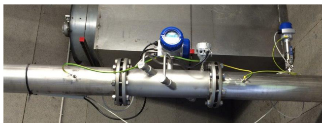
OPTISONIC 7300 Biogaz installé à la sortie du filtre
