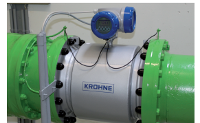
Equipo de medida en funcionamiento
