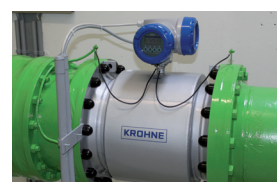
Appareil de mesure en fonctionnement
