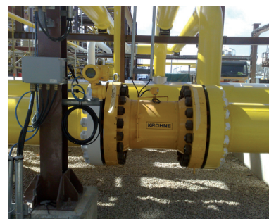
Устройство OPTISONIC 7300 для контроля расхода в процессе хранения газа
