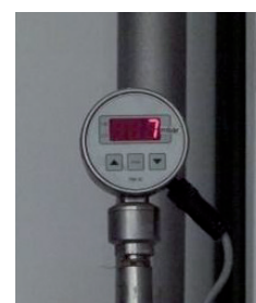
Измерение расхода метана при давлении 7 мбар
