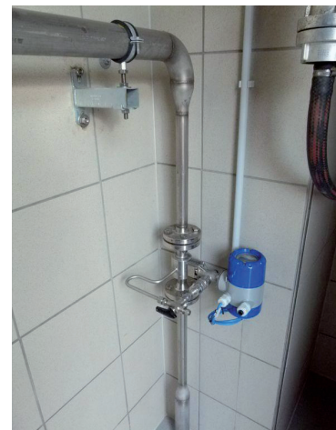
OPTISWIRL 4070 C на нисходящем трубопроводе
