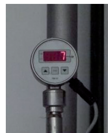
Durchflussmessung von Methangas bei 7 mbar
