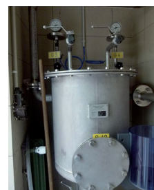
Gaseingang mit erstem Wasserabscheider
