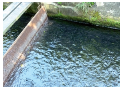
Barrière entre bassins
