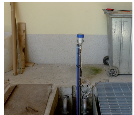
OPTIFLEX 1100 an Messstelle
