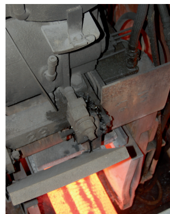
Messeinsatz eines Pt100-Sensoren im Getriebe eines Treibermotors
