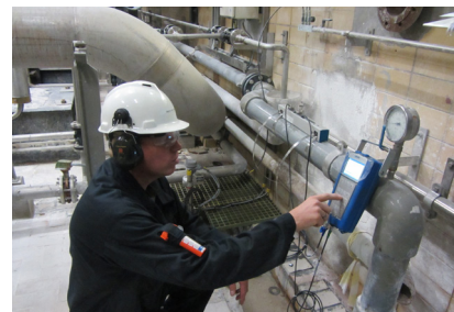
OPTISONIC 6300 P с мобильным преобразователем сигналов, подсоединенным к трубопроводу
