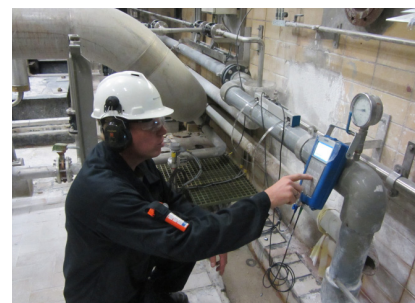
OPTISONIC 6300 P mit kompakter Auswerteeinheit an Rohrleitung
