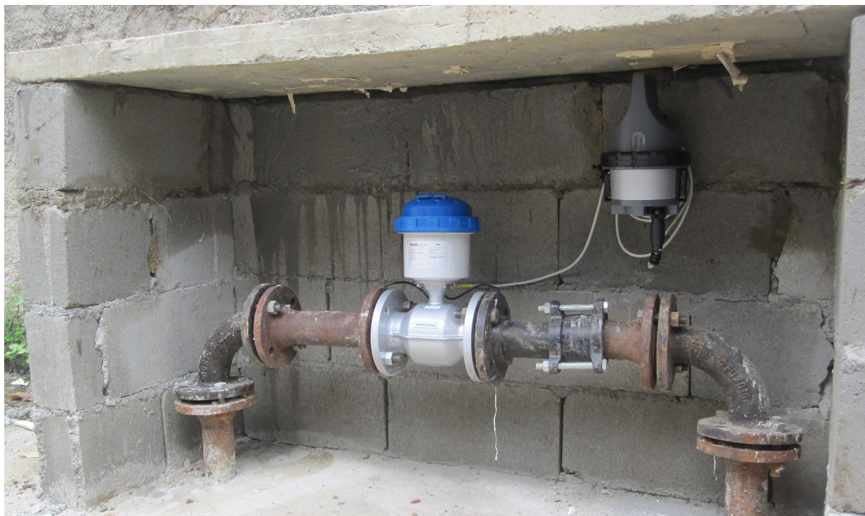
WATERFLUX mit GPRS-Modul KGA 42 in oberirdischer Leitungspartie
