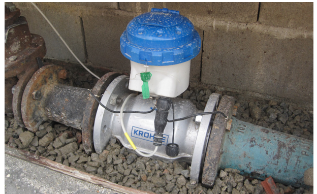
Messrohr durch Kiesbett abgestützt
