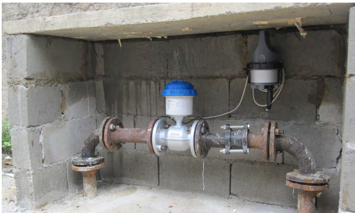
WATERFLUX con módulo GPRS KGA 42 en la parte del tubo sobre el nivel del suelo
