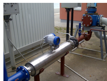
Eichpflichtige Messung mit OPTIMASS 2300 C im Tanklager
