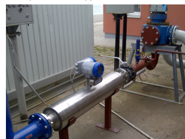
Коммерческий учёт с использованием OPTIMASS 2300 на топливном складе
