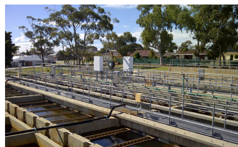
Прибор контроля уровня осадка, установленный на отстойнике
