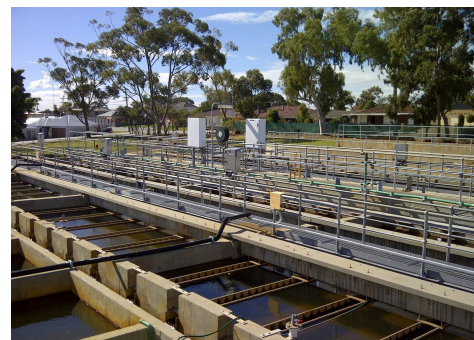
Medidor del nivel de lodos instalado en el tanque de sedimentación
