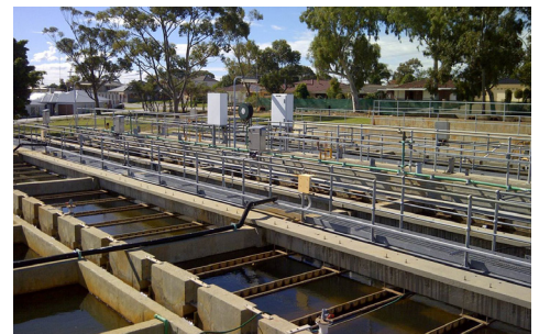
Schlammspiegelmessgeräte an Absetzbecken installiert
