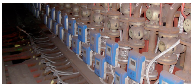
Установленные в контуры охлаждения расходомеры OPTIFLUX 2100 С
