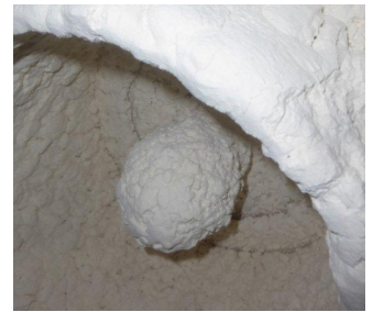
La antena elipsoidal del OPTIWAVE 6300 en un silo de harina
