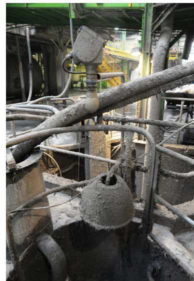
OPTIWAVE 7300, установлен над сборной камерой для технической воды
