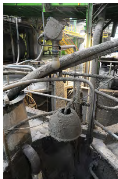
OPTIWAVE 7300, installé au-dessus du puisard de reprise des eaux de process
