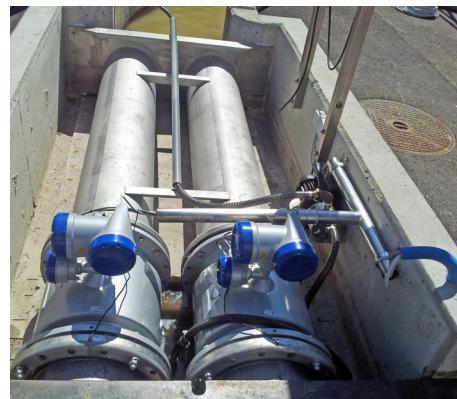
Instalace průtokoměru TIDALFLUX 2300 v kanálu se splašky
